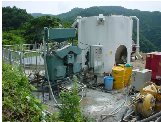
図 5.9.1 二槽式グラウトミキサーおよび小型セメントサイロからなる注入プラントの例
