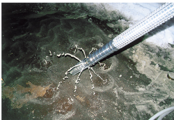
図 1.2.6 耐荷体からのグラウト排出状況
